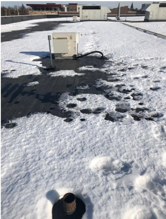
Figure 4 - Mini Split/ Vent Obstructions
